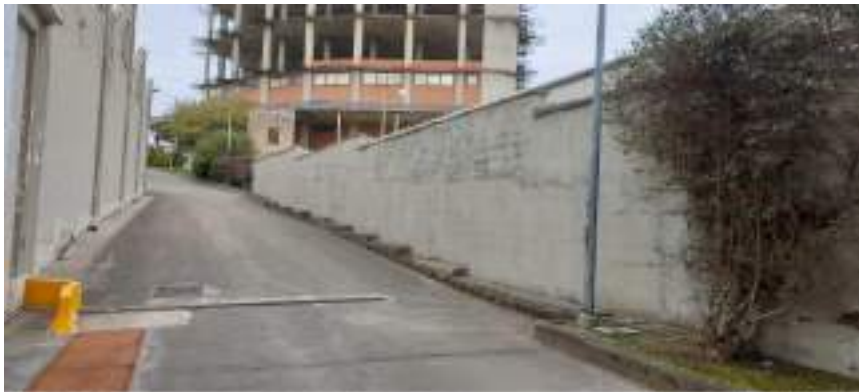
La porzione del muro di confine interessata dall'ammaloramento
